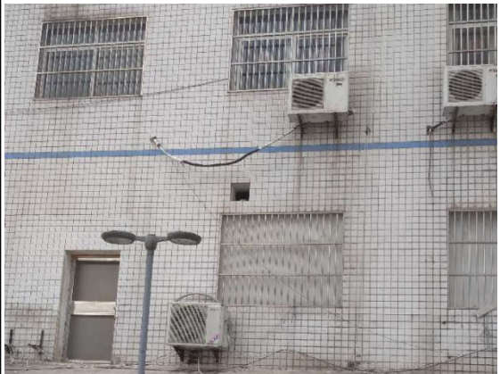
北侧机械排风口
