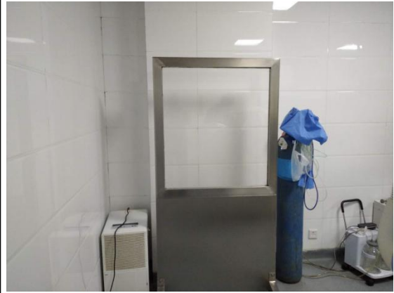
机房内防护屏
